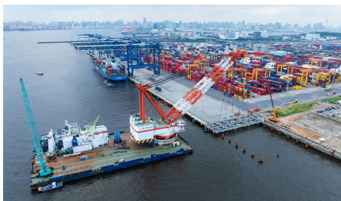
令和 5 年度 東京港中央防波堤外側地区岸壁 (- 1 6 m) (耐震) 築造工事 (東京都 26年2月竣工)
