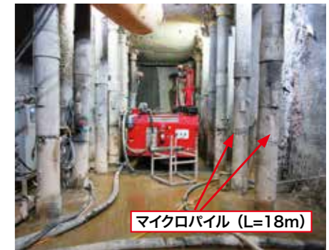
マイクロパイルの打設状況。中ほどに見える連結器で上下2本の鋼管をつなげている
