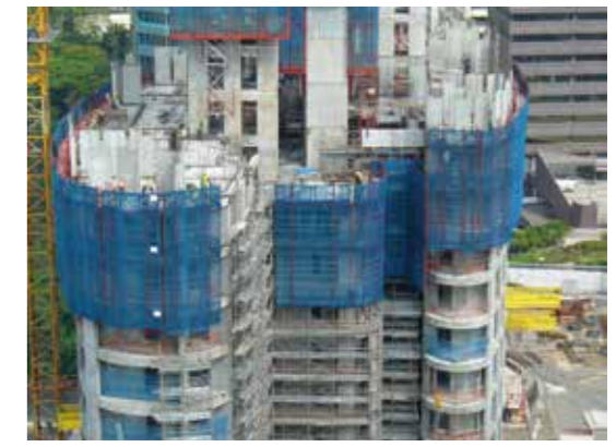
富裕層向けレジデンスを構成するプレキャストコンクリート造の躯体。青いネットに覆われている部分は、墜落や落下物を防ぐ目的で利用するセルフ上昇式の足場
