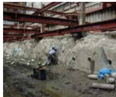
敷地内に残された地下躯体の解体時には音対策が欠かせない。一部の区域では、バースター工法を採用。地下躯体に穴を開け、その中に油圧機械を挿入して圧力を加え、周囲のコンクリートに亀裂を生じさせることで、大きな騒音を発生させずに破碎していく
