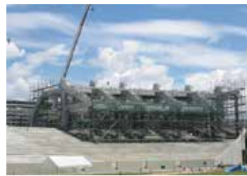
パフォーマンスシート（左側）部分の施工の様子。後方席と違って、階段状の段梁が下方5階部分まで達している
