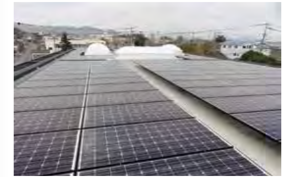
屋上の太陽光パネルは地上から見えないよう勾配を極力減らし、低床タイプの架台を採用して設置した
