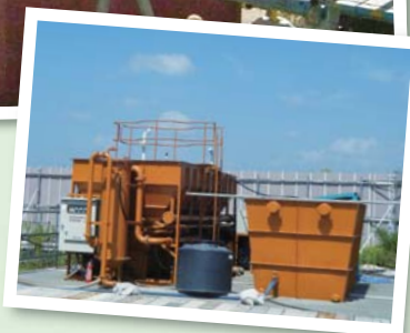
現場内に設置された汚濁処理施設
