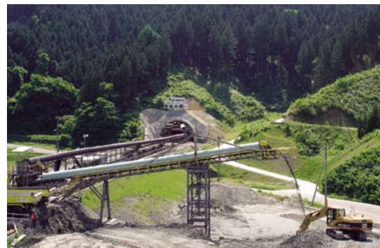
ベルトコンベアシステム
