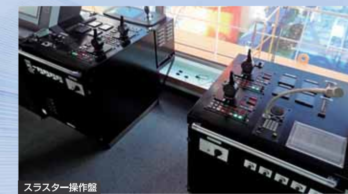
スラスタ操作盤
