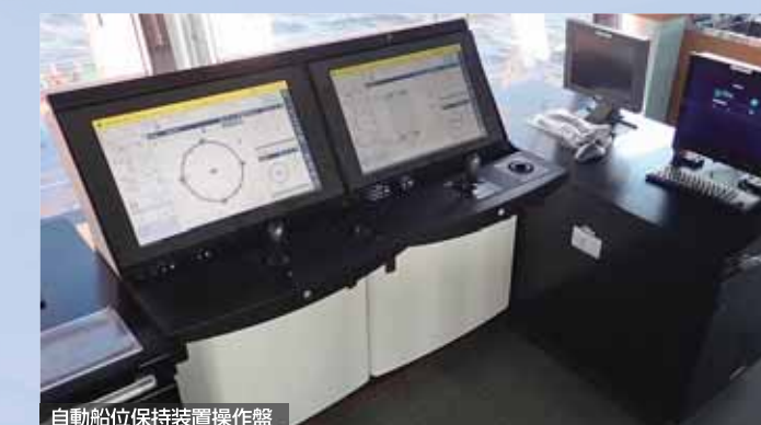
自動船位保持装置操作盤
