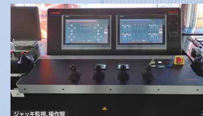
ジャッキ監視、操作盤
